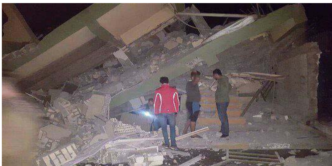
شکل ۴-۲۰: ریزش کامل ساختمان در سلیمانیه عراق
