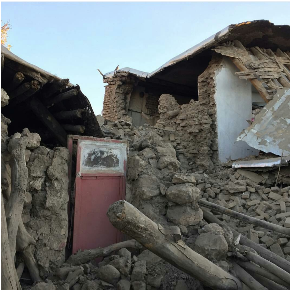
شکل ۴-۲۵: تخریب ساختمان‌های روستایی با مصالح بنایی در روستای دهجایی
