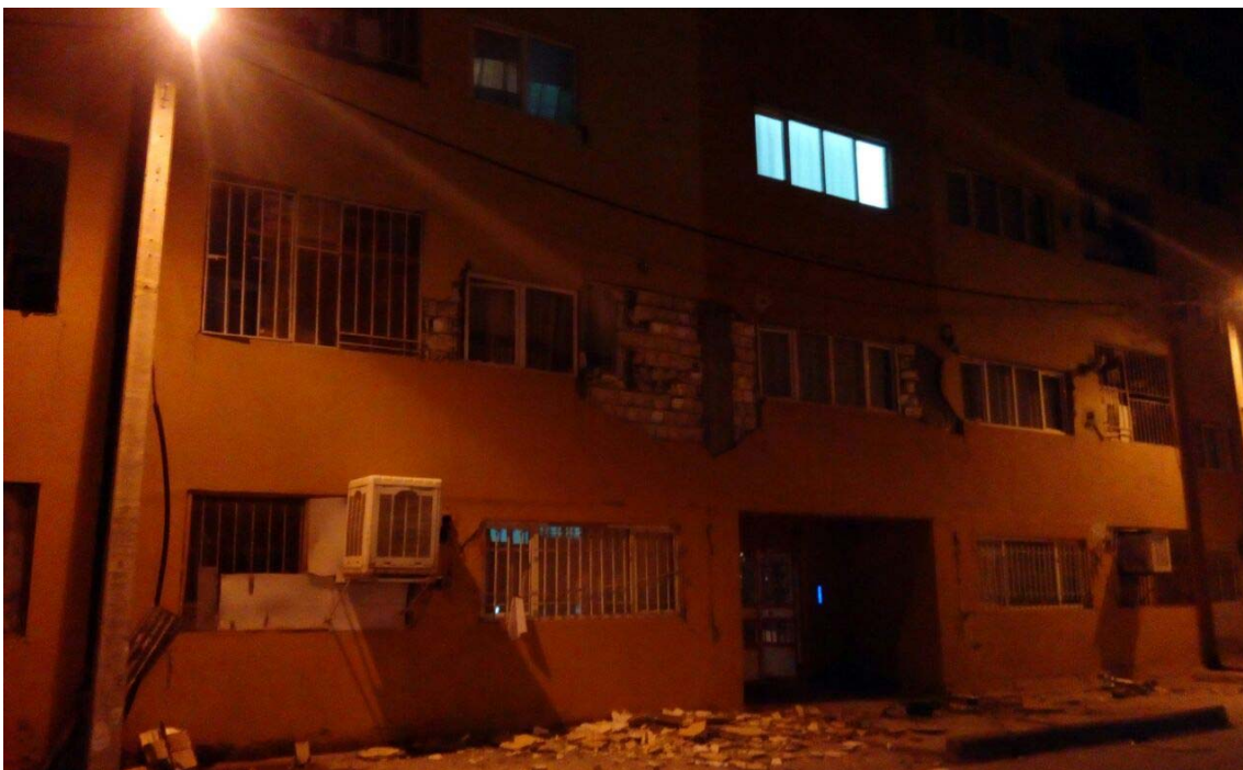
شکل ۴-۱۶: تخریب و ریزش پوشش دیوارهای خارجی در کرمانشاه
