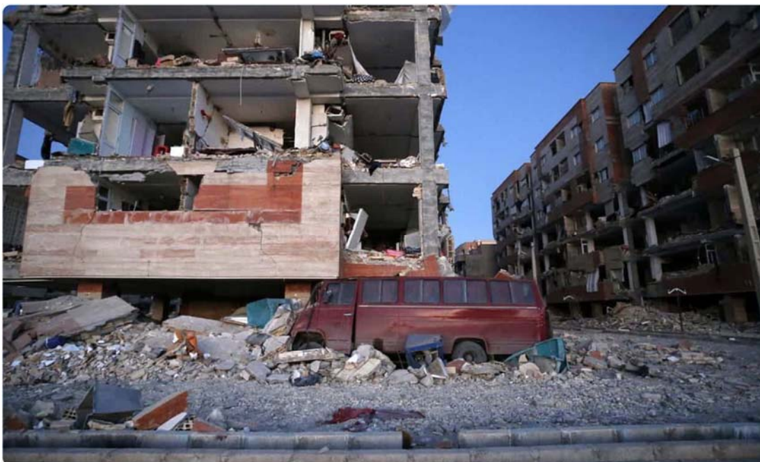
شکل ۴-۱۱: ریزش تیغه ها و دیوارهای پیرامونی در مسکن مهر کرمانشاه
