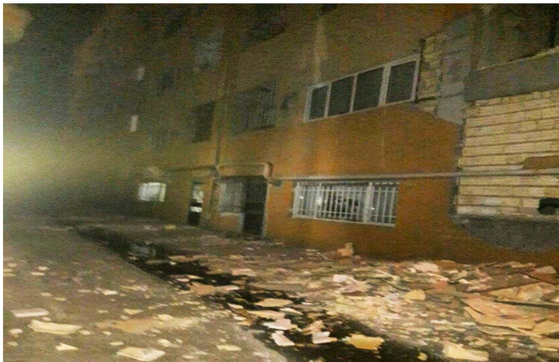
شکل ۴-۶: جدایی و ریزش نمای ساختمان دز معبر عمومی در روانسر کرمانشاه
