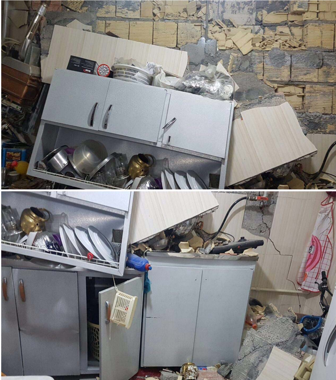
شکل ۴-۱۴: تخریب و ریزش پوشش دیوارهای داخلی در روانسر
